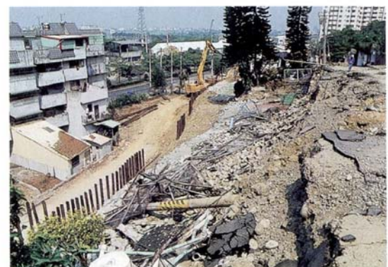
写真-15 地震断層の変位により発生した路肩崩壊(霧峰郷)
