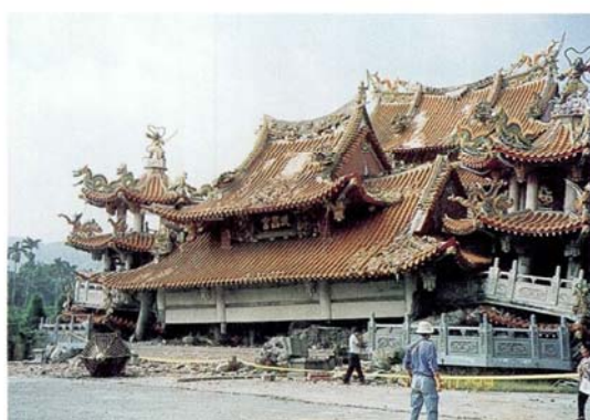
写真-2 集集郊外の軟弱地盤上に建てられた寺院
