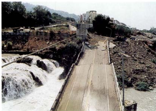
写真-10 地震断層により出現した滝と埤豊橋の落橋
