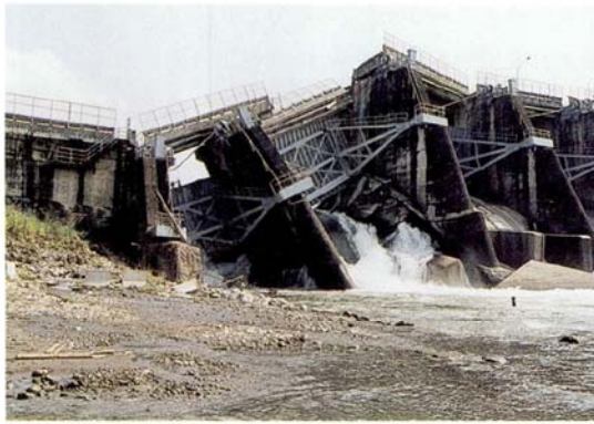
写真-9 地震断層の変位(左右で8～9mの比高)によりせん断破壊した石岡ダム
