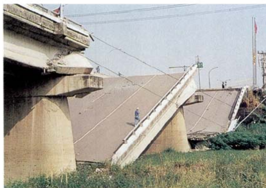
写真-11 地震断層により落橋した烏溪橋
