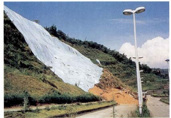
写真-14 埤里郊外の大規模なのり面崩壊
