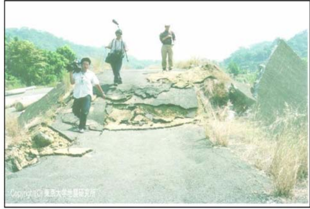
台中県霧峰(東側が1m隆起している。)
