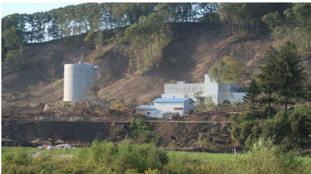
厚真町豊里浄水場（2018年8月に新設されたが、その1カ月後に被災）
