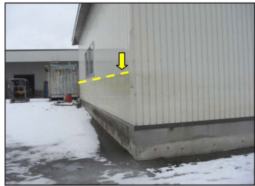
写真 8 津波の痕跡 (図 12 の 8)
