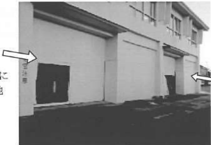
写真41 十勝漁港, 漁協事務所外壁の津波痕跡。
