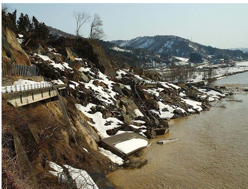
崩落した県道小千谷長岡線(長岡市)
