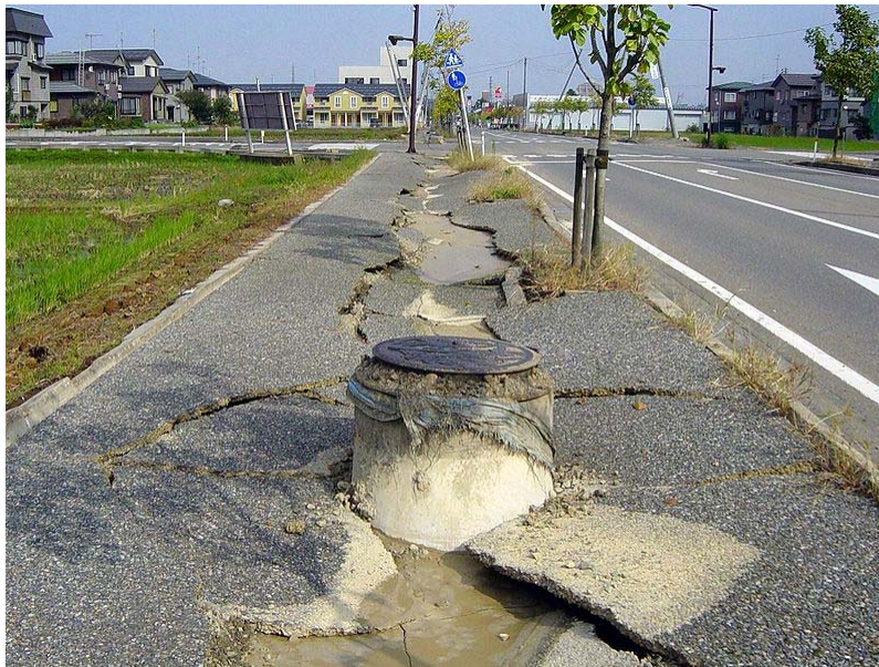
液状化現象により破損した道路(小千谷市)
