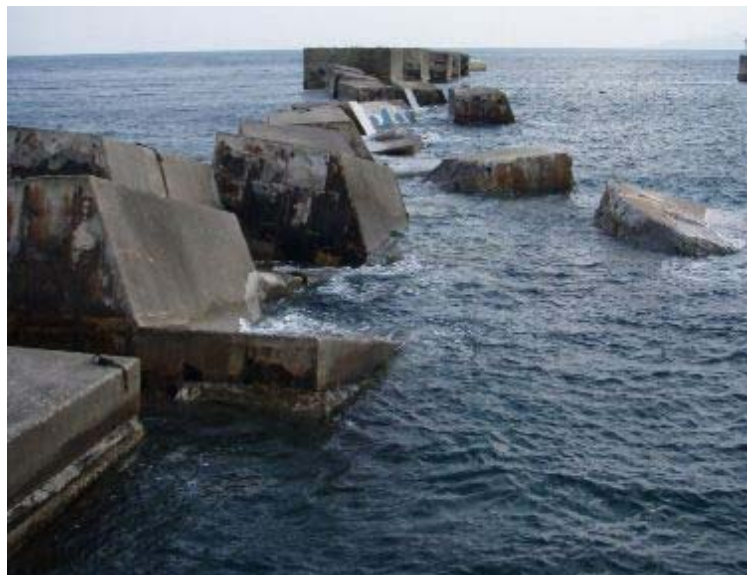
寄り回り波によって被災した護岸(北小浦漁港)
