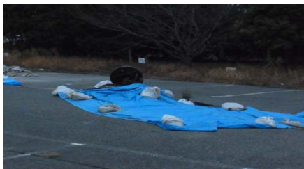
写真2 マンホールの浮上
