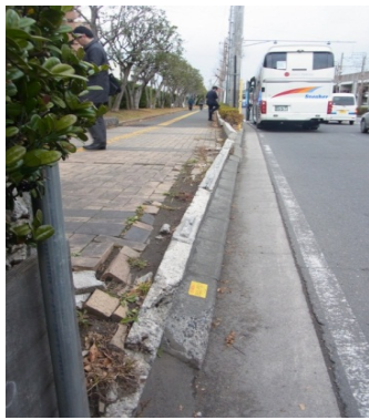
写真1 液状化により、歩道が傾いている様子
