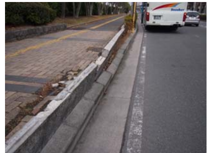
写真 1 新浦安駅周辺（2012 年 12 月 18 日撮影）
