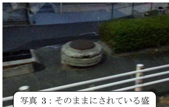
写真2: 盛り上がったマンホール 浮き上がった駐車場
